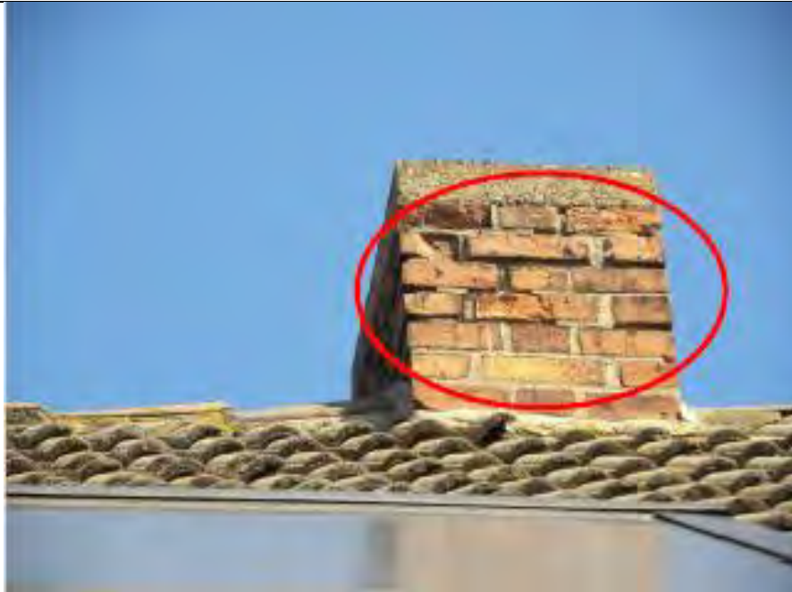
Zustand der Schornsteinköpfe
