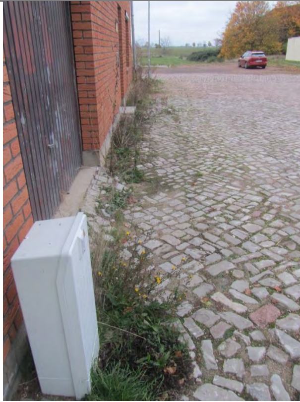
Stromverteiler befindet sich vor dem Garagentor.
