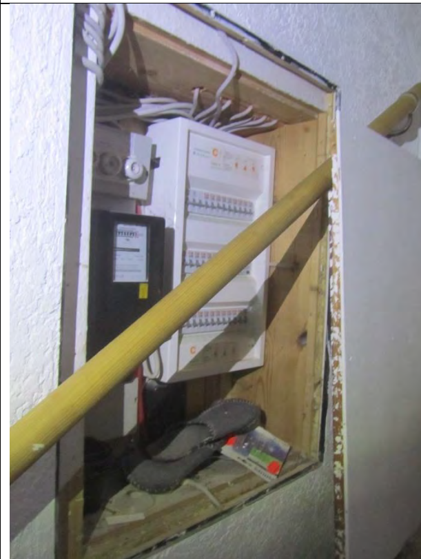
Am Eingang links, Bereich Treppenaufgang befindet sich der Verteilerkasten für die Elektrik sowie der Stromzähler.
