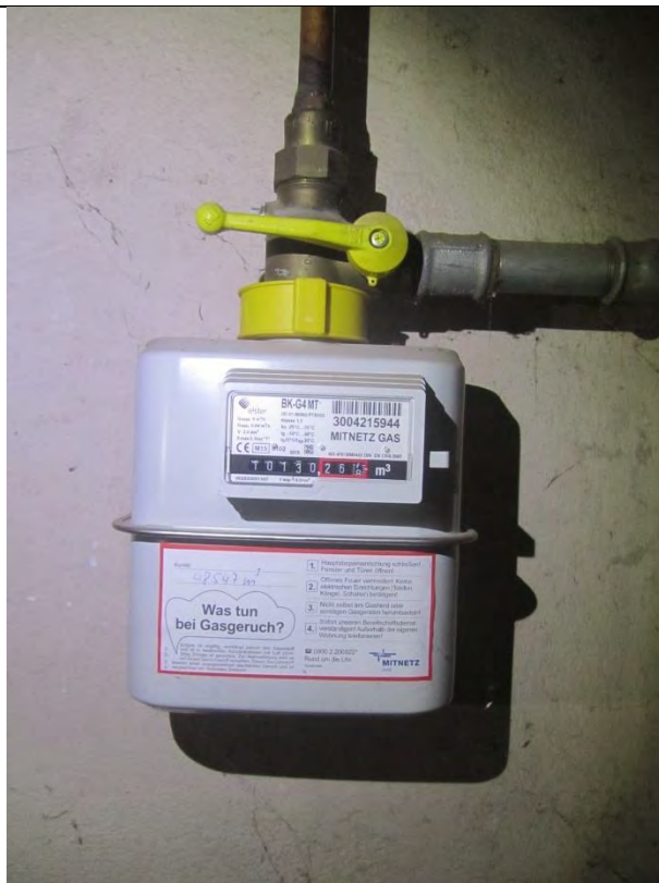
Gasuhr befindet sich in der Garage.
