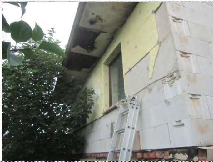
Südfassade von der Bauruine
