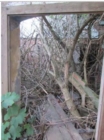
chem. Tür in der Lehmruine, die völlig verwuchert ist
