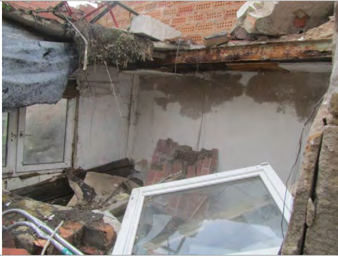
Blick nach SW – durch das Fenster gelangt man in den Gartenteil und zu den anderen Teilen der Bauruine
