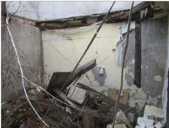
Veranda nach W eingestürzt; Bauschutt; sonstige Ablagerungen
