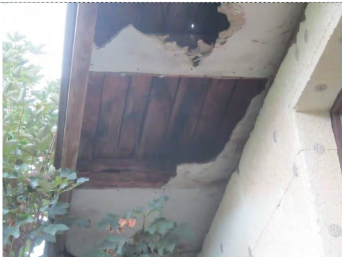
Balken vom Dach sind verfault
