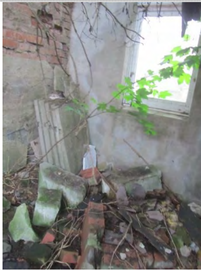
Blick nach W - Bauschutt und Müll
