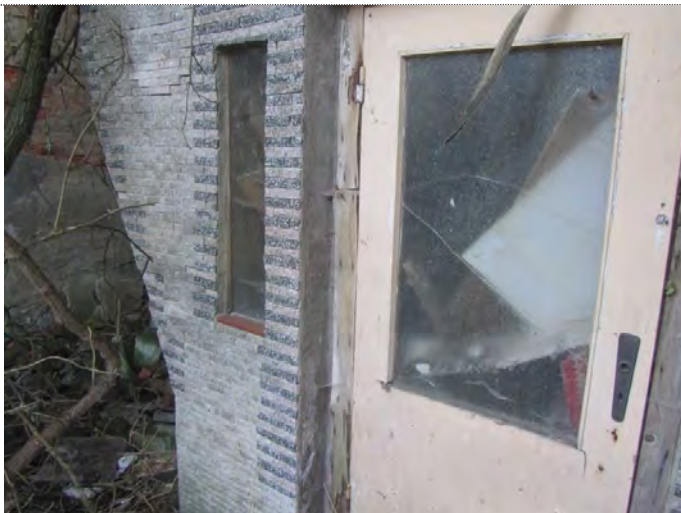
rechts vom Zugang der Ruine - ehem. wohl geplanten Zugang mit eingestürzter Decke
