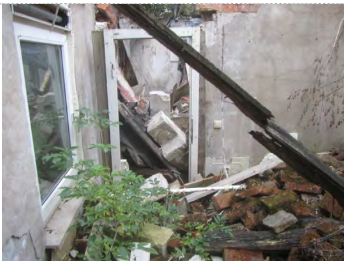
weiter nach S hinter der Veranda ein weiterer Raum – alles eingestürzt; links das Fenster gehört zum eingestürzten ehem. Zugang
