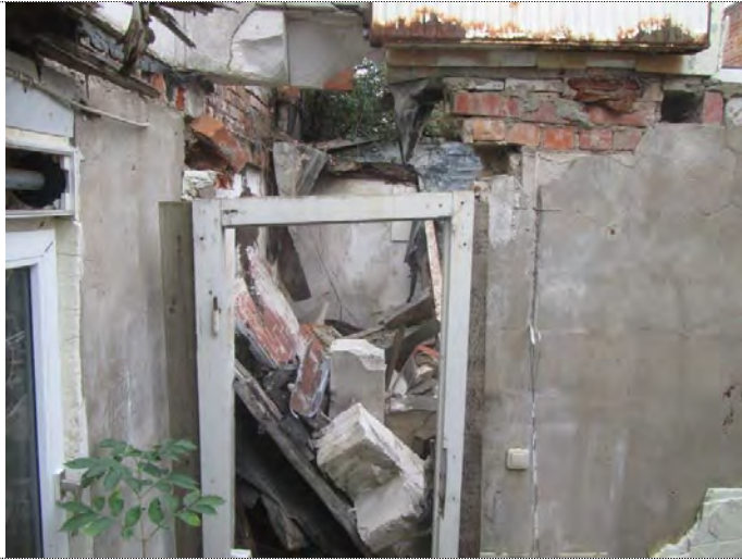
weiter nach S – alles zerstört
