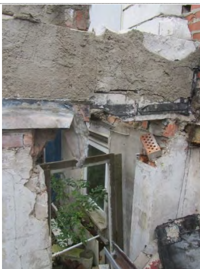
Veranda nach N – alles desolat und eingestürzt
